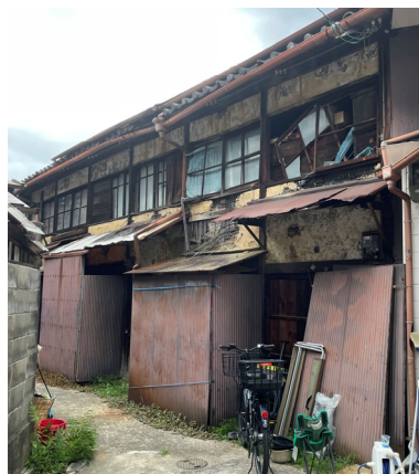
工事前外観。朽ち果てる一步 手前の危険な状態
