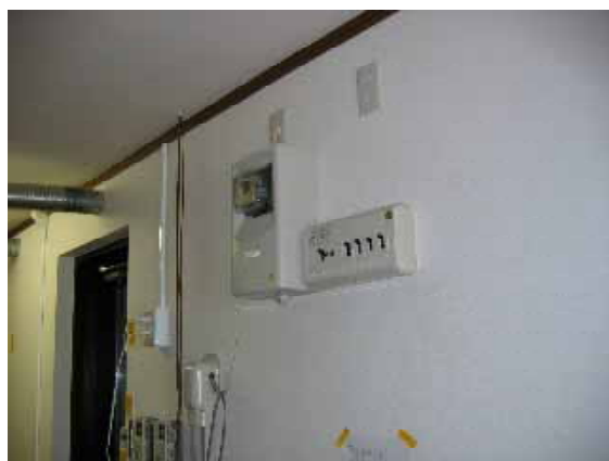
写真1-16 実験室に設置されている電力計
