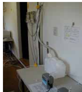
写真1-13 エアコンドレイン水のタンクへの捕集状況
