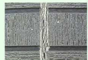
外壁シーリング材のひび割れ*
