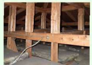
天井上断熱材の敷込み不良
