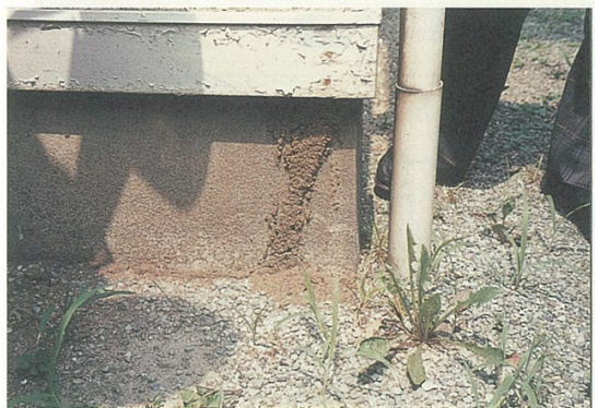
基礎部分の蟻道＝「蟻害等」
