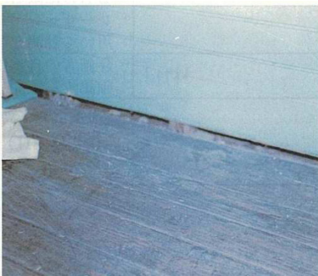
「床の傾斜」が想定される床・壁取り合い部の間隙
