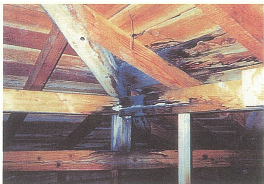
小屋裏の「雨漏りの跡」
