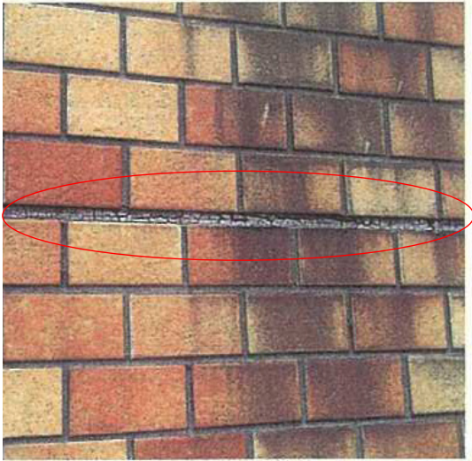
シーリング材の破断
