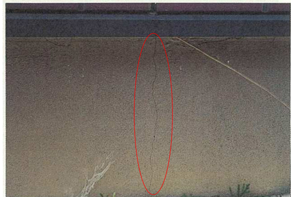
「著しいひび割れ」とされないひび割れ
