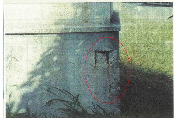
基礎の「著しい欠損」
