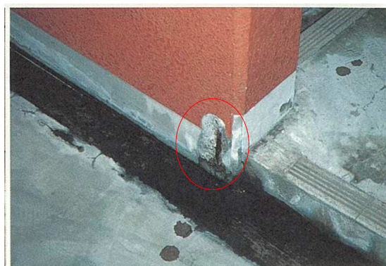
外壁の「著しい欠損」
