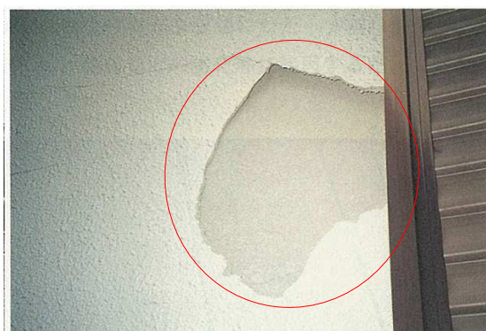
モルタルの「著しい剥がれ」
