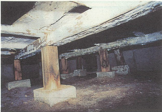
床下部分の腐朽
