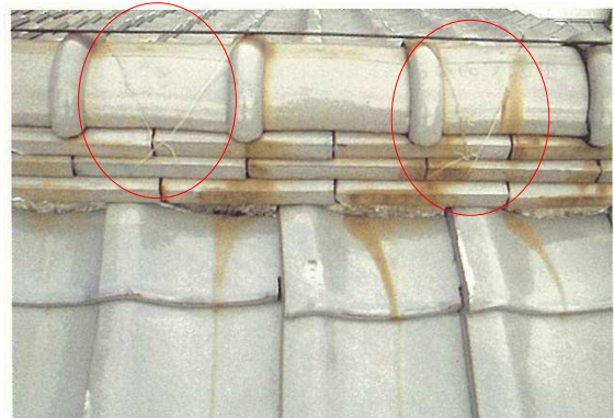
留め付け銅線の腐食
