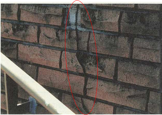
タイルの「著しいひび割れ」
