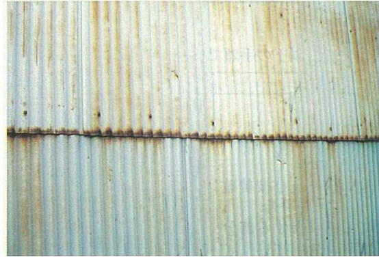
金属板の「著しい腐食」
