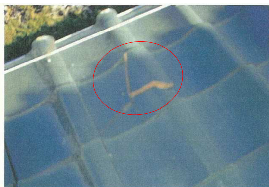
粘土瓦の「著しい割れ」
