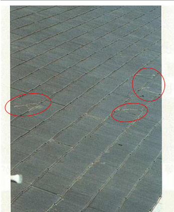
屋根用化粧スレートの割れ
