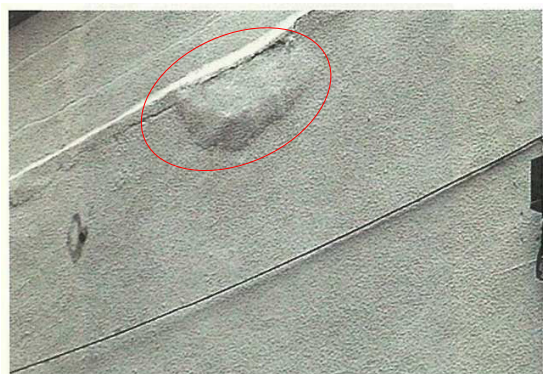
モルタルの「著しい浮き」
