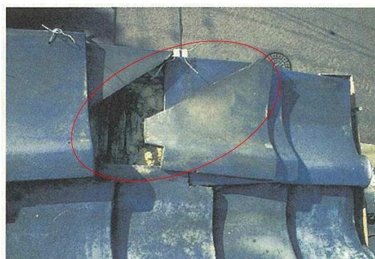
瓦の「著しい割れ」を伴う「著しいずれ」
