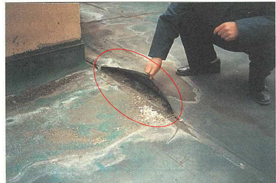
ルーフィング接合部剥離
