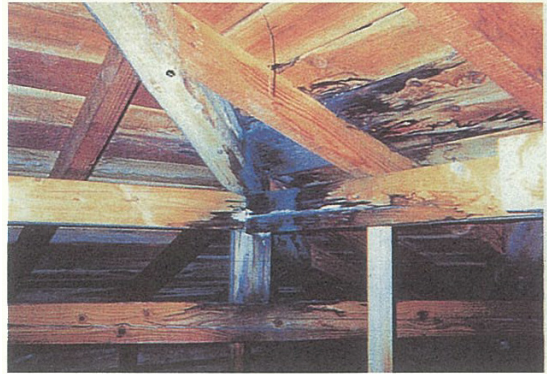
小屋裏の雨漏り部分の腐朽
