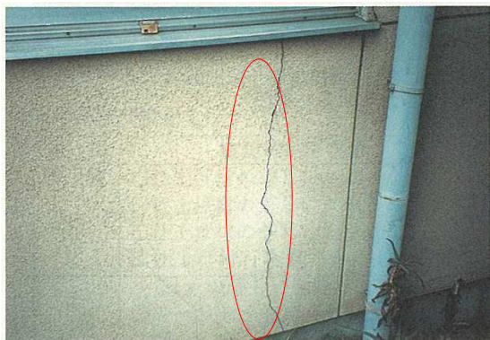
モルタルの「著しいひび割れ」
