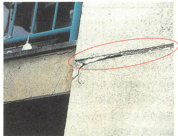
シーリング材の接着破壊
