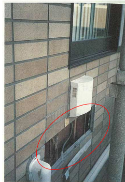
タイルの 「著しい欠損」
