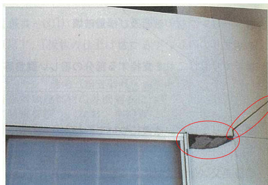
モルタルの「著しいひび割れ・欠損」
