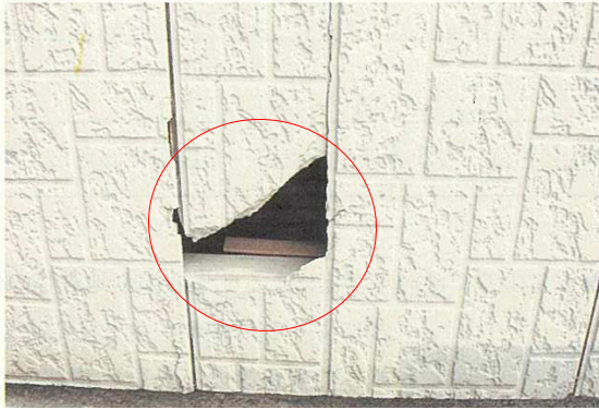
仕上材の「著しい欠損」 (窯業系サイディング)
